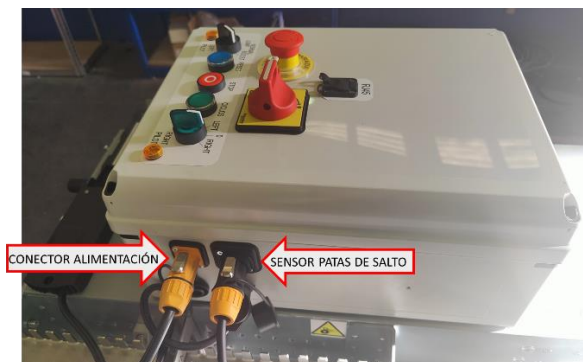
Lateral Derecho Cuadro Control
